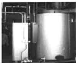
蒸気ボイラー
